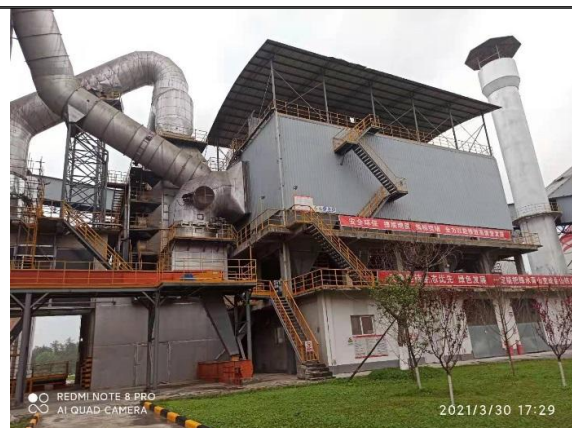
窑尾废气处理设施（余热锅炉）
