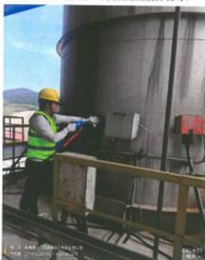
窑尾废气出口(不焚烧危险废弃物时)
